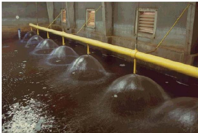
شکل ۱۰- استفاده از فواره ها در هوادهی آب
